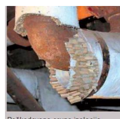
Poškodovana cevna izolacija
